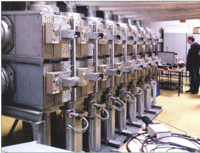
Antennenschaltmatrix; in der Sendestelle Wertachtal füllte sie ein ganzes Gebäude ...
