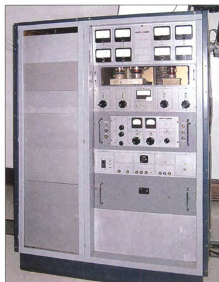
Bild 4: Bei CHU sind solche KW-Sender aus den 1960er-Jahren im Einsatz.
