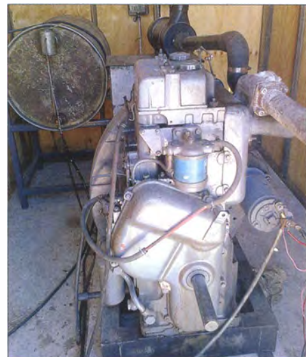
Der kräftige Notstrom-Dieselmotor fängt sämtliche Strom-Unannehmlichkeiten ab.
