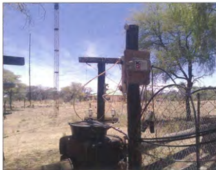
Beginn der Zweidrahtleitung mit 12:1-Balun (zum Kühlen im Ölbad-Topf)
