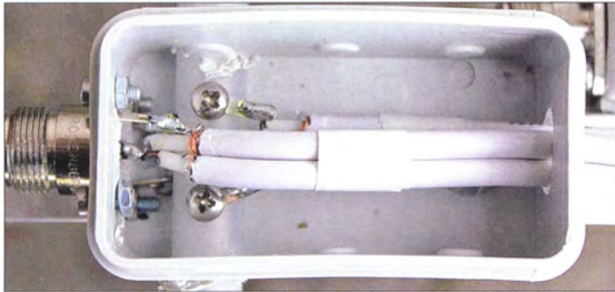
Bild 5: Strahlerdose mit fertig angeschlossener Transformationsleitung
