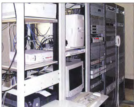
Bild 2: Kontrollraum von CHU Ottawa
